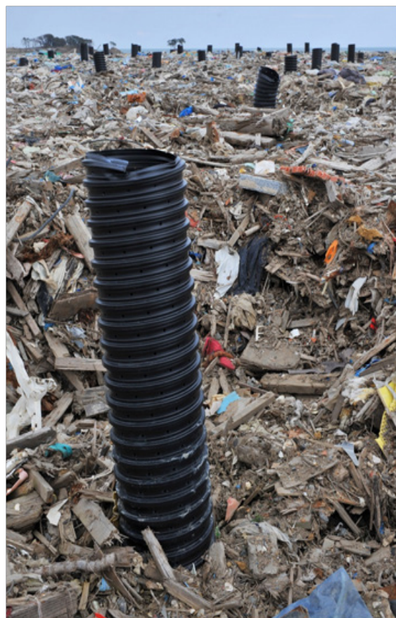
防災対策用に埋められた熱や可燃ガスを抜く管
